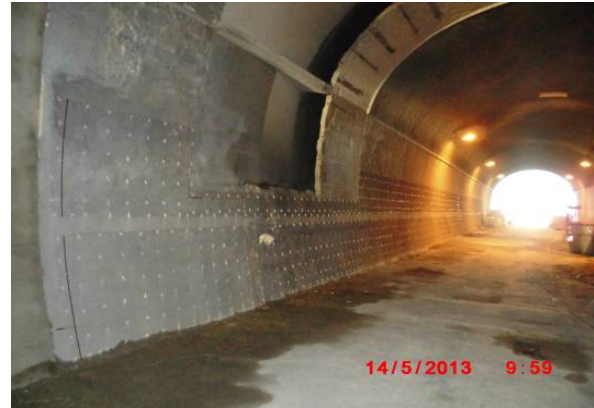
Bild 14: Montage der Anode an der Tunnelwand mit Aussparung im Bereich der Belüftungsöffnung
